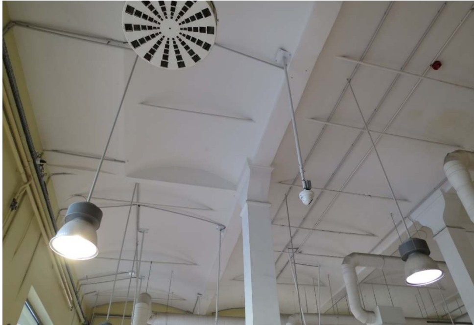
A földem tartószerkezete: (téglapillérekén álló) öntöttvas oszlopok, vasgerendák közti lapos téglák (vb?) boltozatok, vonóvasak
